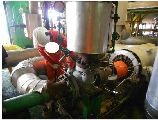
Figura 5.7: Intervenção no flange da MB-B Fonte: fotografia realizada em campo pela autora
