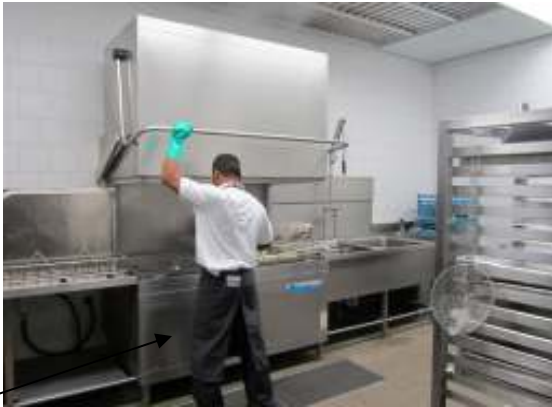
Figura 58: Lavadora de louças que faz reuso da água
