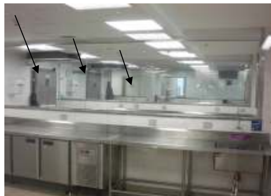
Figura 82: Câmaras frigoríficas setorizadas
