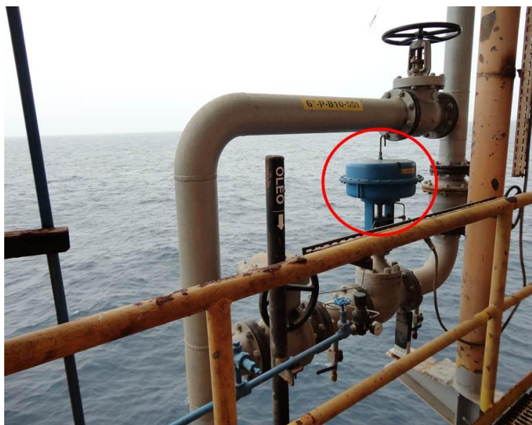
Figura 19 – Válvula do controle do dreno do sistema de selagem, em P-C
