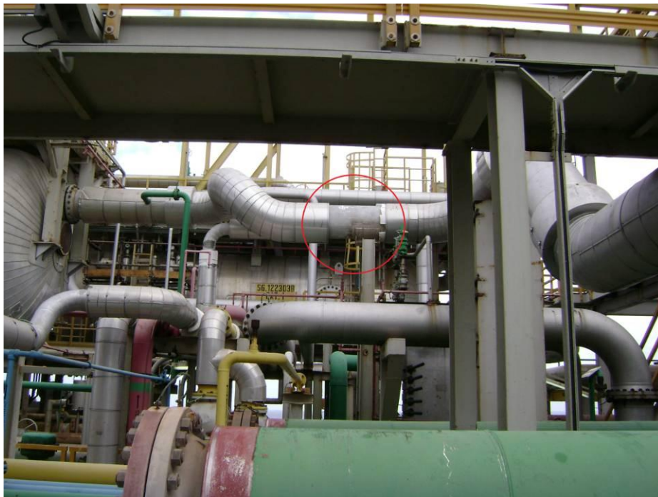
Figura 15 – Isolamento térmico retirado de tubulação
