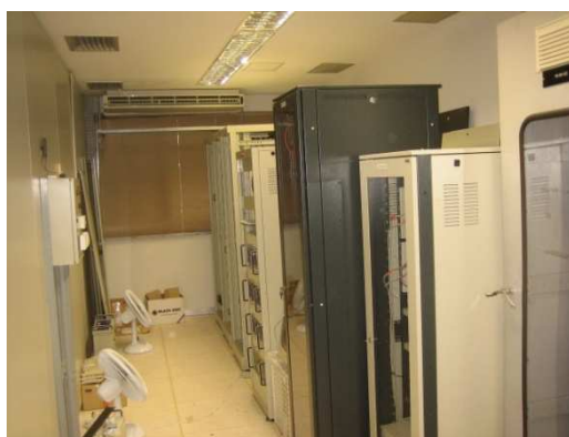
Figura 16 – Sala de Equipamentos
