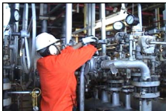
Figura 50 - Manuseio de válvula de equalização no lançador de PIG
