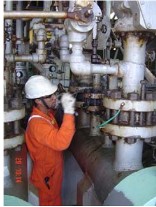
Figura 46 – região de acesso obstruída para a lubrificação dos flanges e estojos
