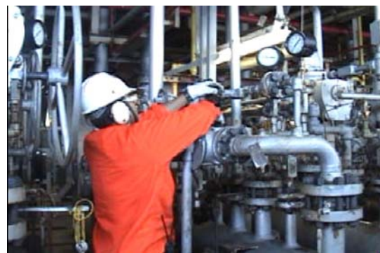
Figura 32 – manuseio da válvula equalizadora na entrada do lançador
