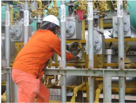
Figura 35 – acesso ao volante de by-pass da PSV no módulo 3A
