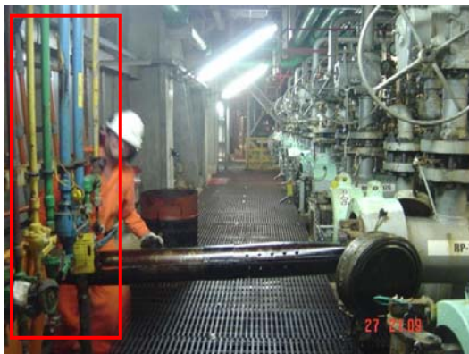
Figura 47 - obstruções na região à frente do receptor do poço BR-06
