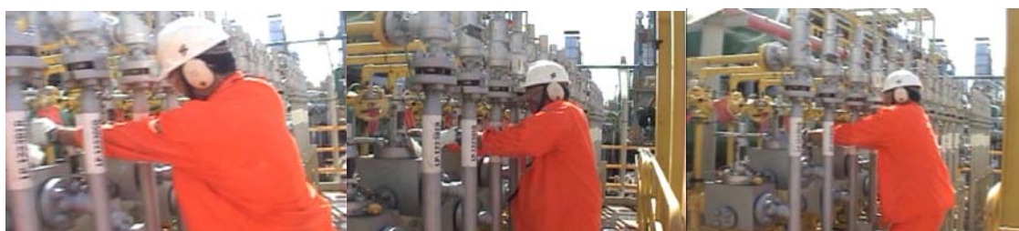
Figura 24 - atuação manual na válvula de by-pass da PSV
